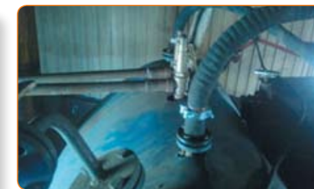
Верхний барабан котла с присоединенными рукавами подачи реагента
