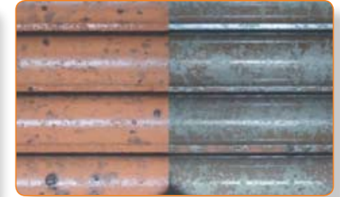
Трубы жарового пучка «ДО» и «ПОСЛЕ» очистки
