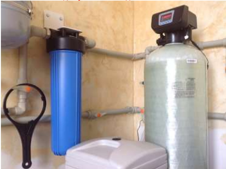
Рис. 1 Установка для умягчения воды в системе автономного водоснабжения
